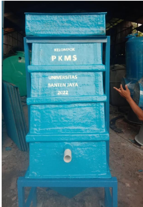
Gambar 3. Instalasi Pengolahan Air Limbah Batik Banten (Dokumentasi pengabdian, 2022)
