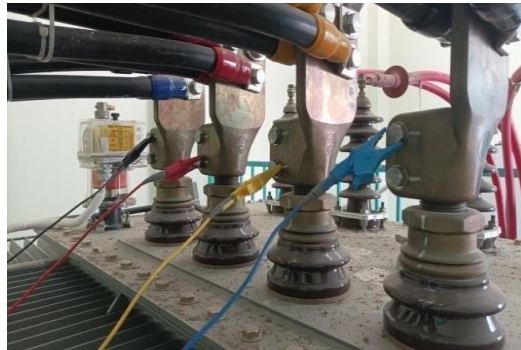
Gambar 2. Pemasangan Alat Ukur pada Sisi Skunder Trafo 2.000 KVA Unimus
