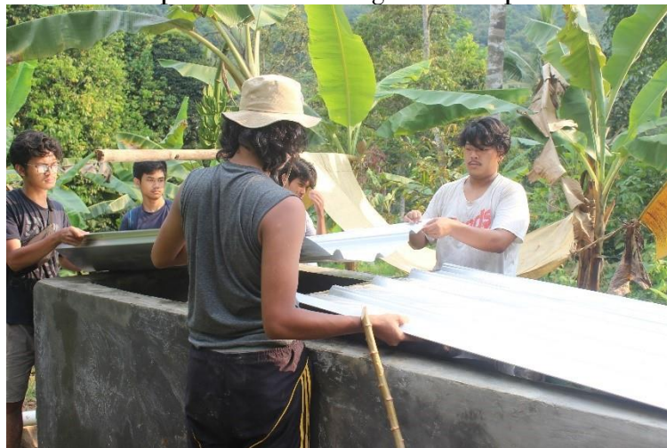
Gambar 5: Penutupan bak kontrol agar air tetap bersih
